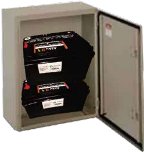
ARMARIO CON 2 BATERÍAS
